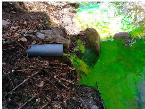
Photo d'un rejet direct d'eaux usées dans une rivière
