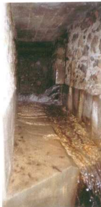
Vue n°4 Couloir latéral de direction N 16° Arrivée d'eau d'un autre couloir (N114°)
