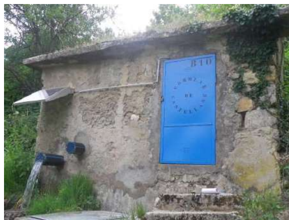
Captage de Basse Lagne
