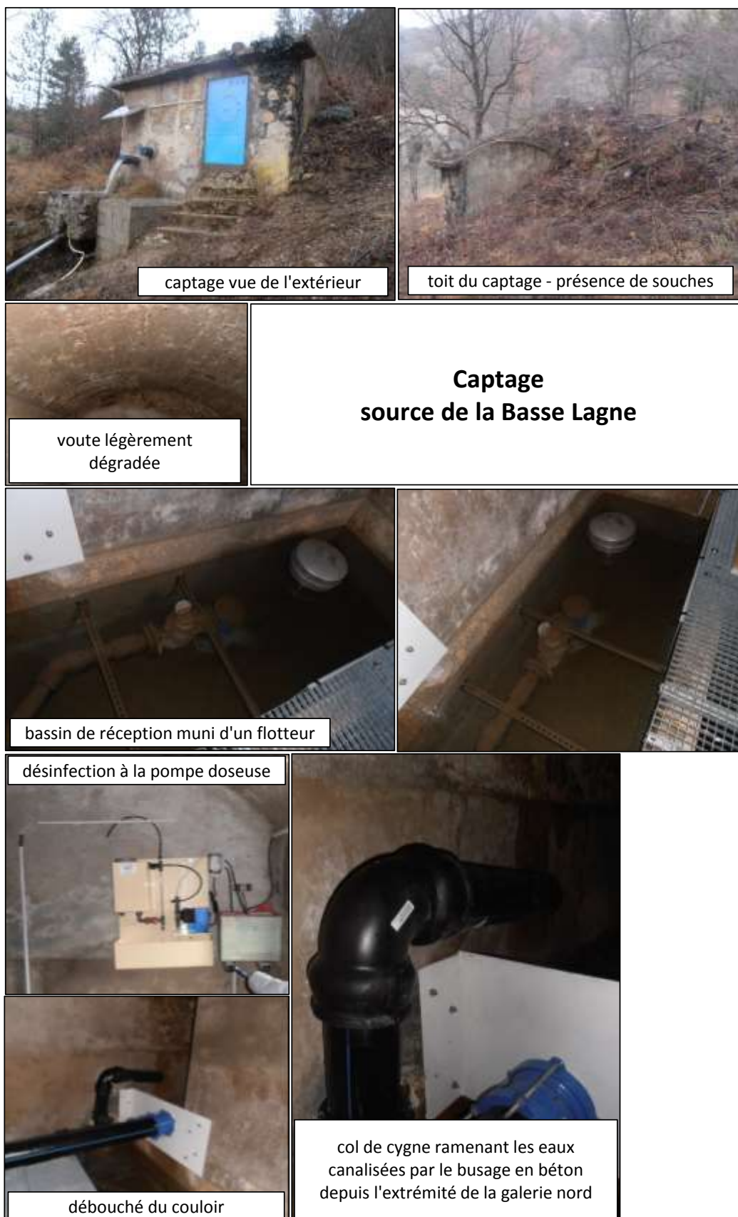
Figure 6 : clichés photographiques du captage de la source de la Basse Lagne
