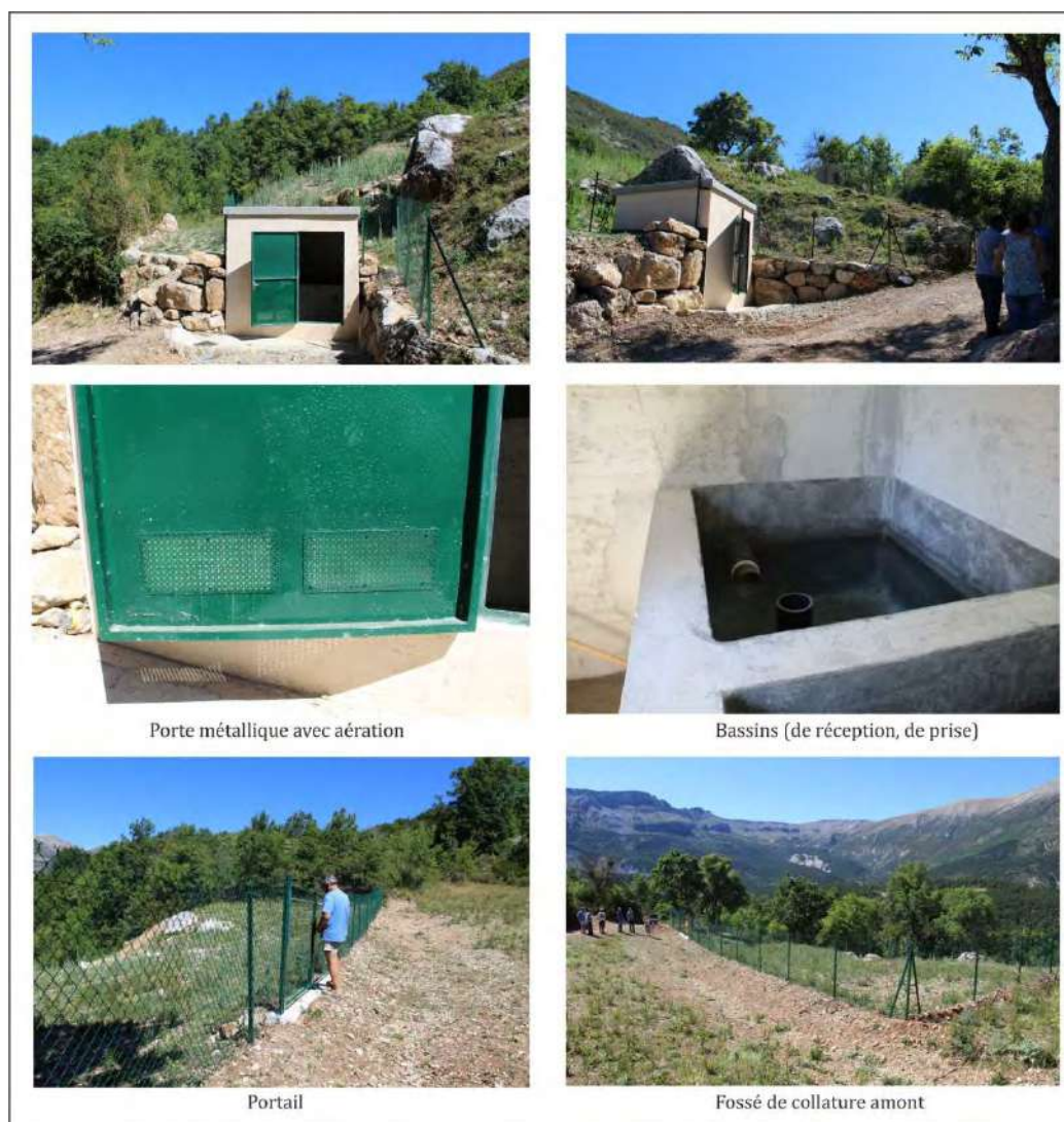
Figure 3 : Captage de la source des Ferrayes
