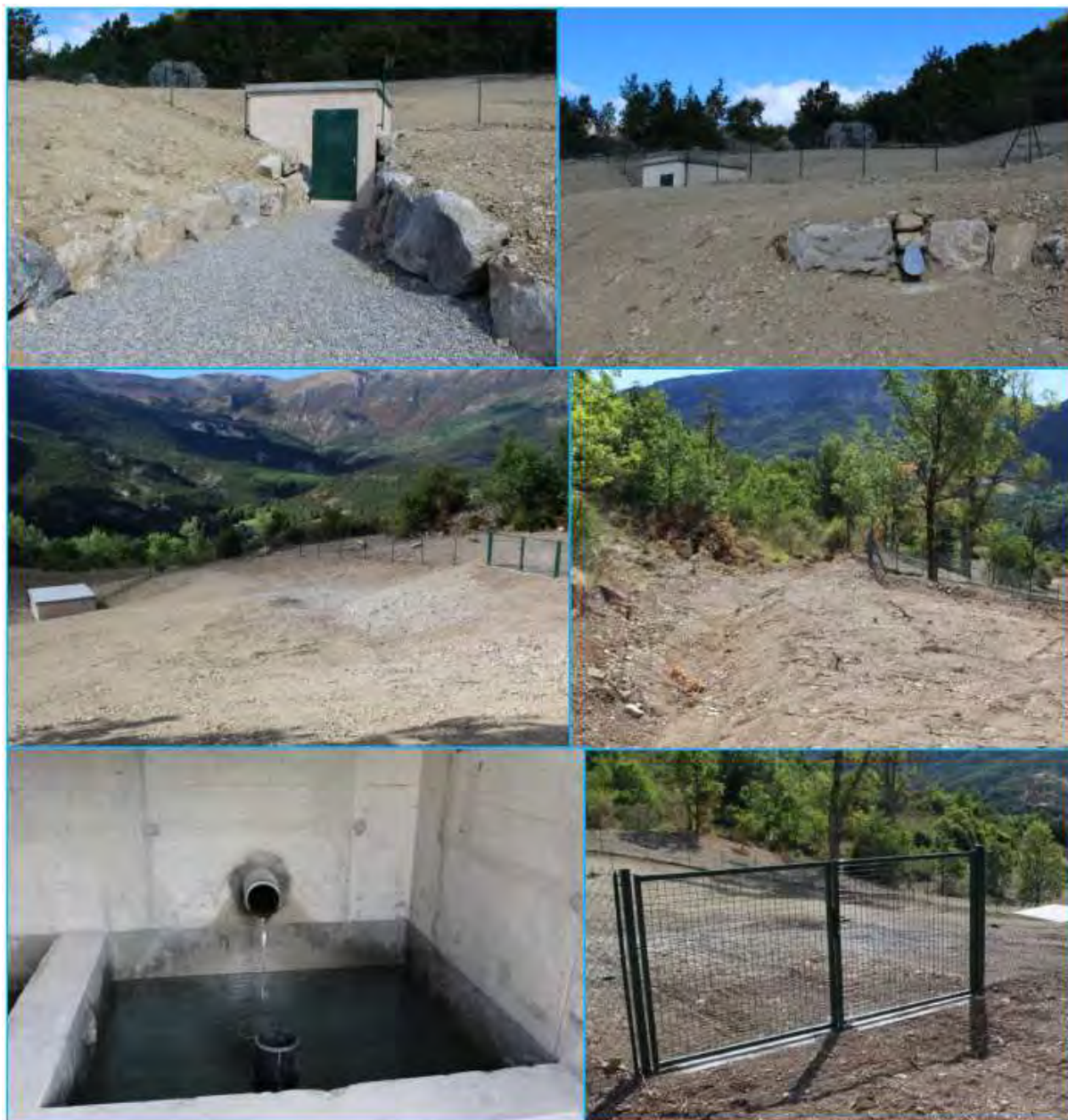
Figure 3 : Captage de la source de Briges (photos Géosynergie)
