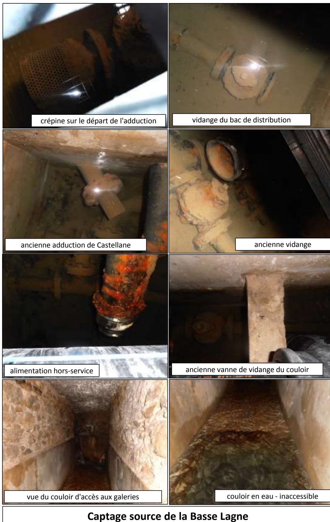
Figure 7 : clichés photographiques du captage de la source de la Basse Lagne
