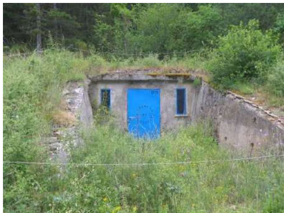
Captage de La Lagne
