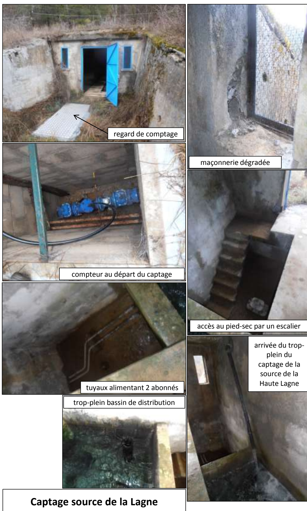
Figure 4 : clichés photographiques du captage de la source de la Lagne
